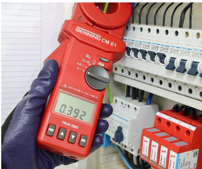
Messung des Gesamt-Ableitstroms in einer Unterverteilung.
